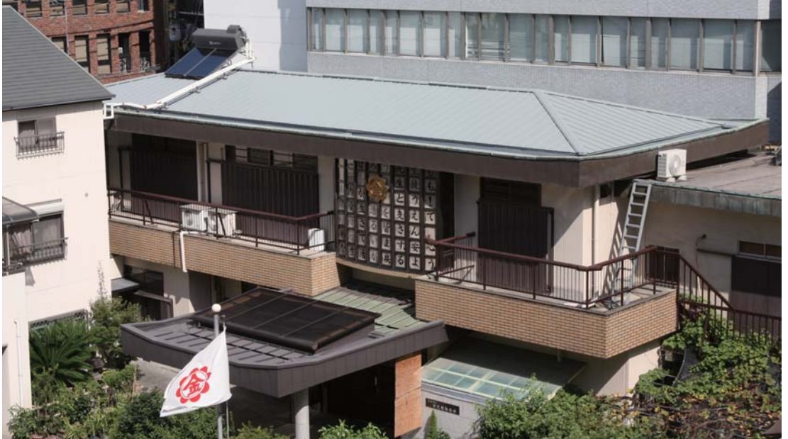
教会屋根葺き替え工事を終えて、きれいになった大屋根(7月27日)
